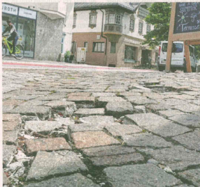
Im gepflasterten Reuttener Untermarkt waren auch gestern mehrere großflächige „Einbrüche“ und Unebenheiten zu finden.
