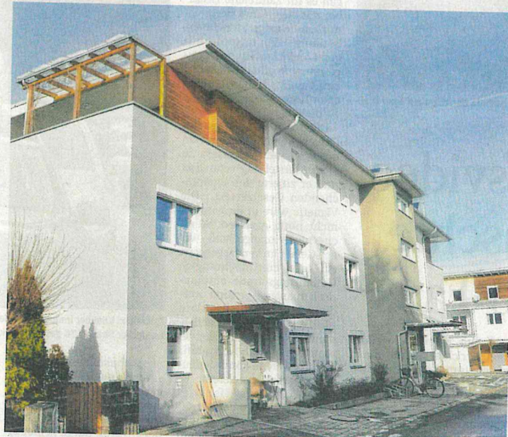
Große Erleichterung verspüren die Miteigentümer einer Reuttener Wohnanlage – sie haben den Schadenersatzprozess gegen den Bauträger gewonnen und können nach dem Winter Fenster und Mauerwerk sanieren. Foto: Mittermayr
